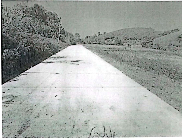
ก่อสร้างถนน ค.ส.ล หมู่ที่ ๑๐ ทางไปฟาร์มหมู
